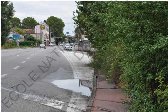
Fig.30 Disparition du trottoir
