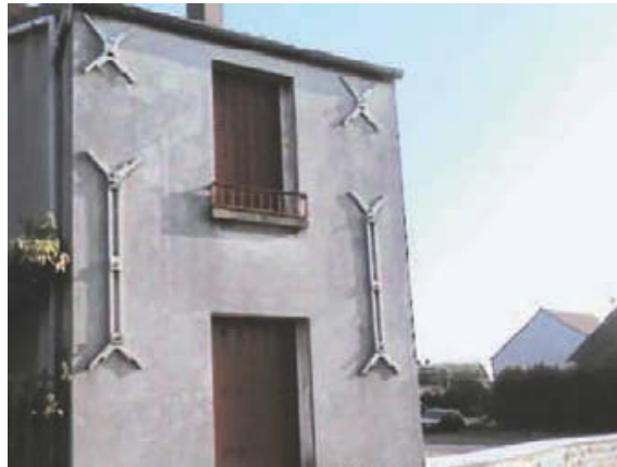
Figure n° 7 : Tirants d'enserrement en Région Parisienne
