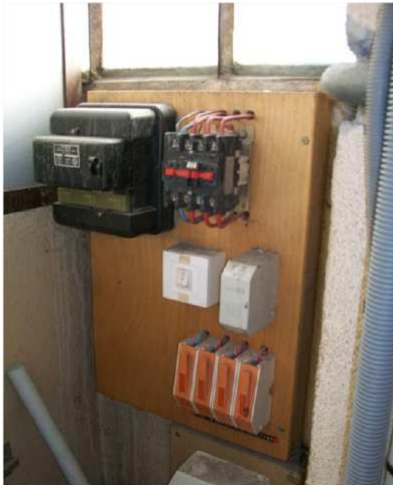
Figure 42 : coffret de commande de la commune de Saint Jean de Maurienne
