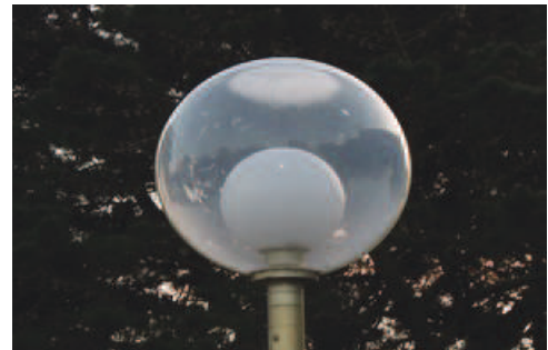
Luminaire à remplacer
