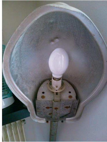
Figure 21 : luminaire avec une lampe à vapeur de mercure
