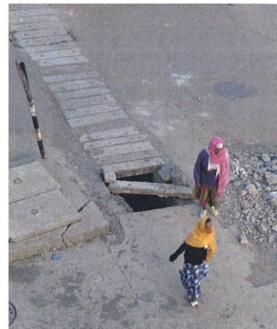
Figure 36 Conditions de marche difficiles Source : Caux, 2012
