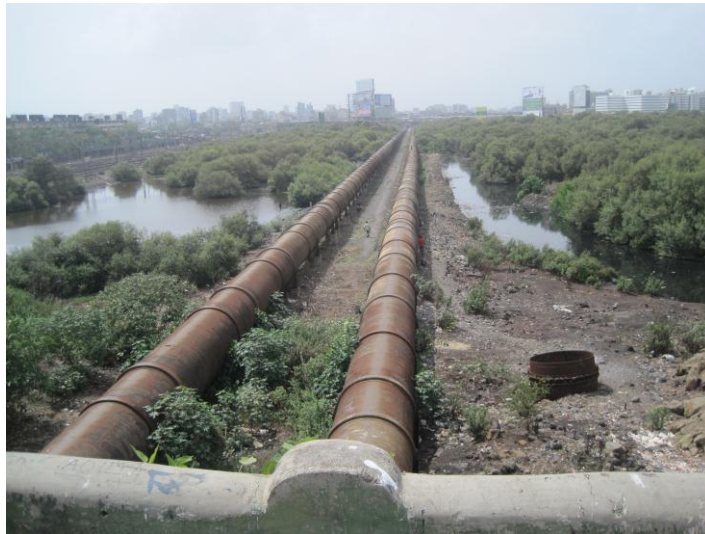
Tuyauteries approvisionnement de l'eau à Dharavi, vue vers le secteur de Bandra
