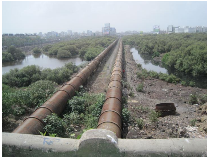
Tuyauteries approvisionnement de l'eau à Dharavi, vue vers le secteur de Bandra
