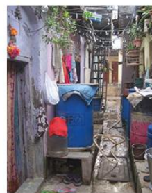
Distribution de l’eau Tuyau de caoutchouc
