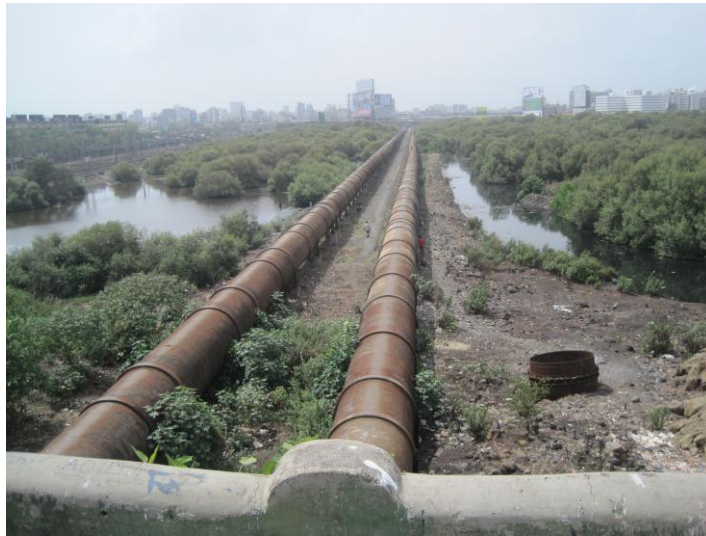
Tuyauteries approvisionnement de l'eau à Dharavi, vue vers le secteur de Bandra
