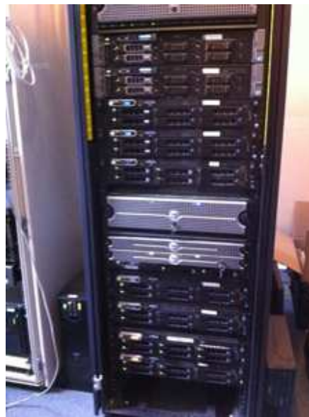
Vue de la baie une fois montée dans son armoire (photo : P.Caujolle)
