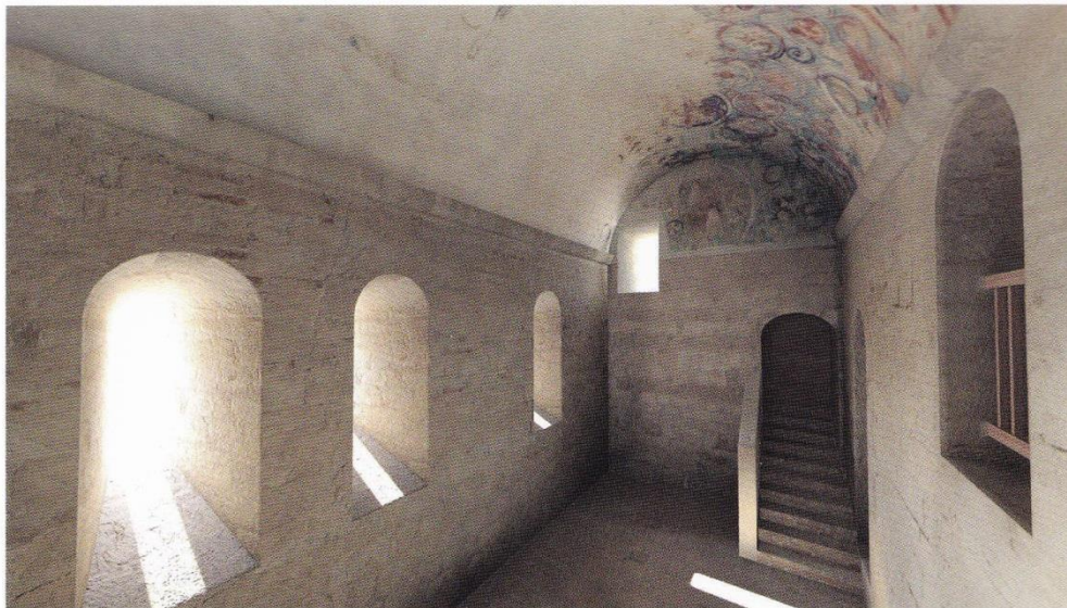
Fig. 6. État de la chapelle au xix siècle. Ouverture d'une fenêtre dans le mur ouest. La lumière et l'air qui entrent par cette ouverture ont asséchés l'enduit et causés la perte des décors du côté sud de la voûte.
