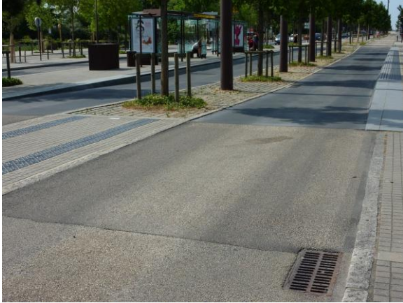
Insertion en station entre le revêtement hydro-décapé du site propre, la jonction en enrobé percolé et le béton de remplacement en station
