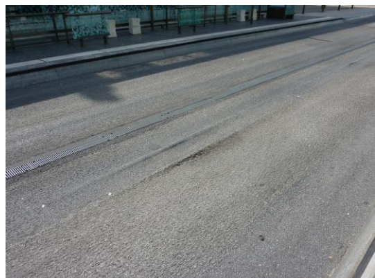
Orniérage visible en station sur le revêtement d'origine
