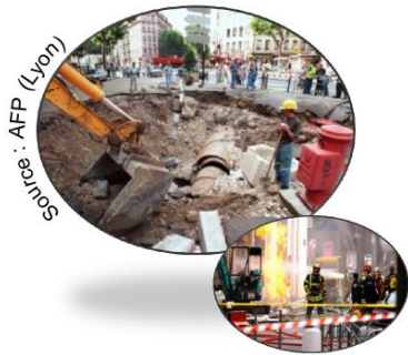
Figure 37 : Accidents et endommagements de réseau
