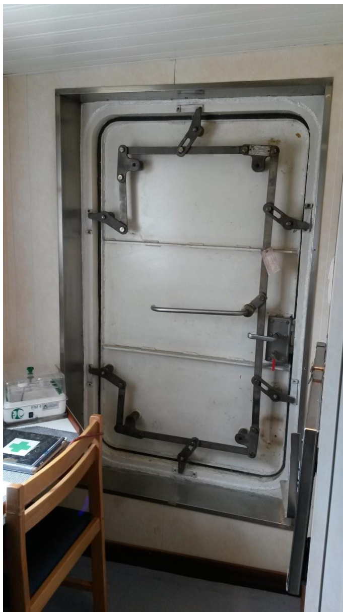
Figure 49 Infirmerie sortie de secours
