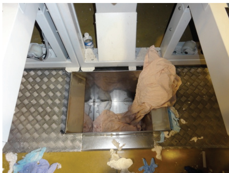
Figure 15. Fosse en regard de chaque poste d'engagement grand plat.
