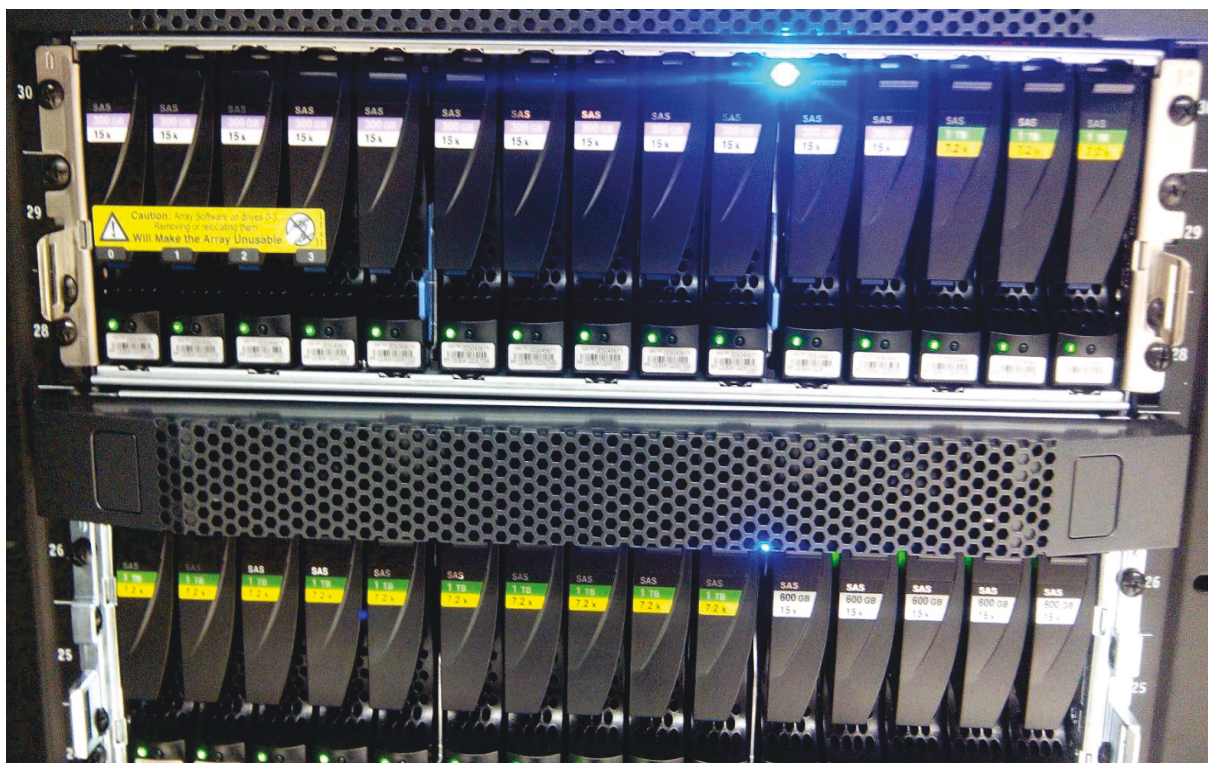
Figure 16 - Photo des disques de la baie EMC, pools et disques
