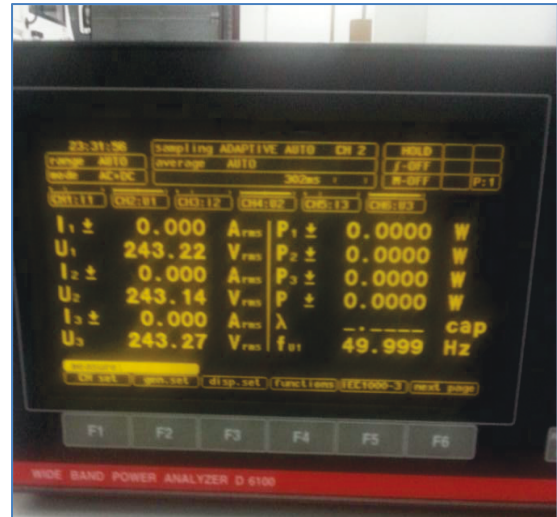
Figure 3.55. Analyseur de puissance
