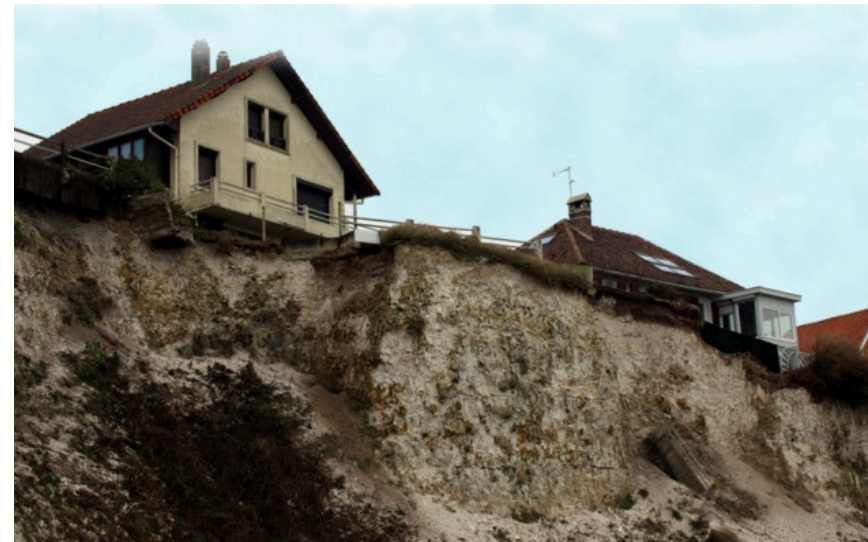
Figure 27: Erosion à Criel-sur-Mer, source : l'informateur 2013
