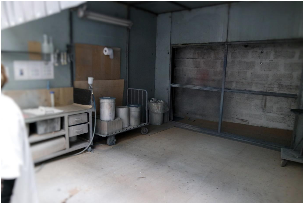
Figure 7 : Cabine de pulvérisation manuelle de Gelcoat
