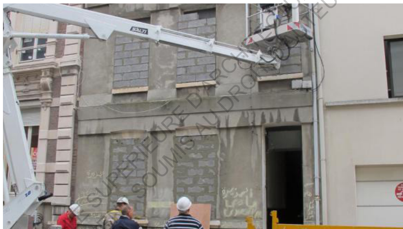
Murage d'un squat à Calais rendant le lieu inaccessible
