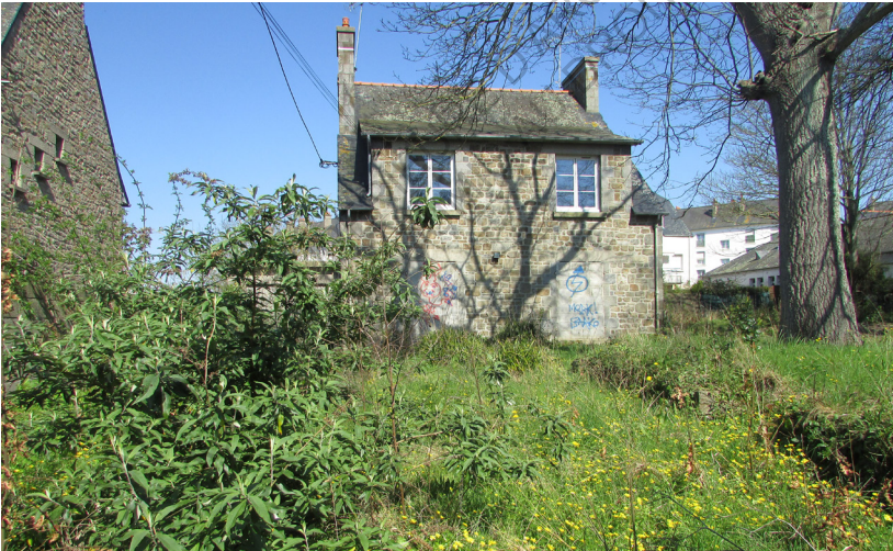
Maison vacante depuis une durée déjà importante comme en témoigne l'état de son jardin. On remarque le signe intersquat taggué en bleu sur l'entrée murée.
