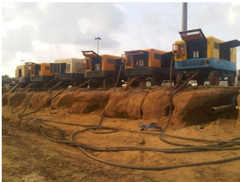
Figure 21 – Vue de la batterie de compresseur
