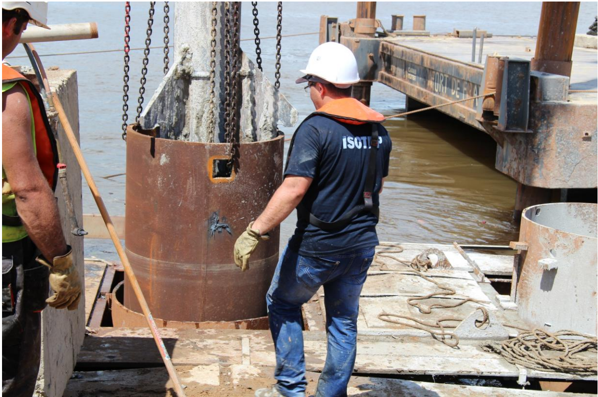
Figure 63 - Mise en place de la racine à l'aide du pieu de 406 dans le tube de 1220
