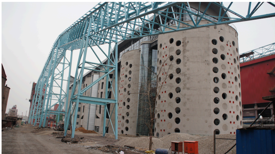
Image 20 : les six silos en 2015 : le projet de la Place Créative des dix silos de stockage de l'ouest en cours de réalisation Photographie de ZHANG Yunxi 29-03-2015
