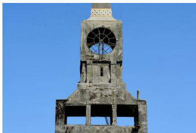
Fig 9: Tour florentine en mauvais état, Buire, crédit photo : lunion.fr
