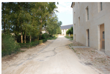
Fig 47: Érosion du chemin périphérique, crédit photo: Urbaterra
