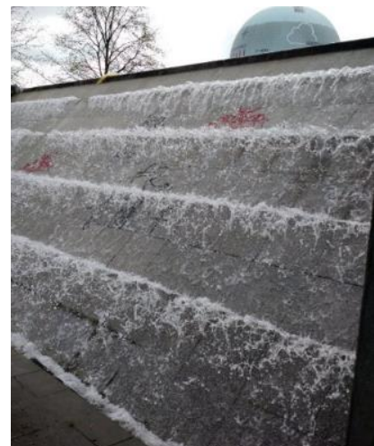
Figure 2 : Cascade recouverte de graffitis, les nombreuses pièces d'eau du parc rendent l'entretien compliqué (crédit photo : K.Piddy)
