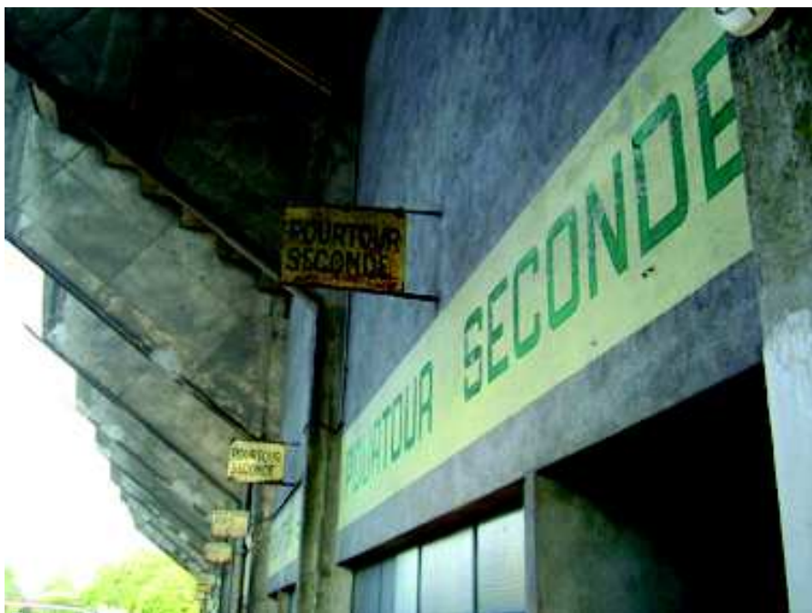
Vue de la sous face de la tribune Oscar Müller avant rénovation
