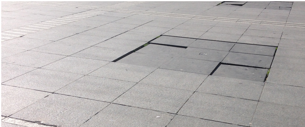
Mauvais état des carrés de granit
