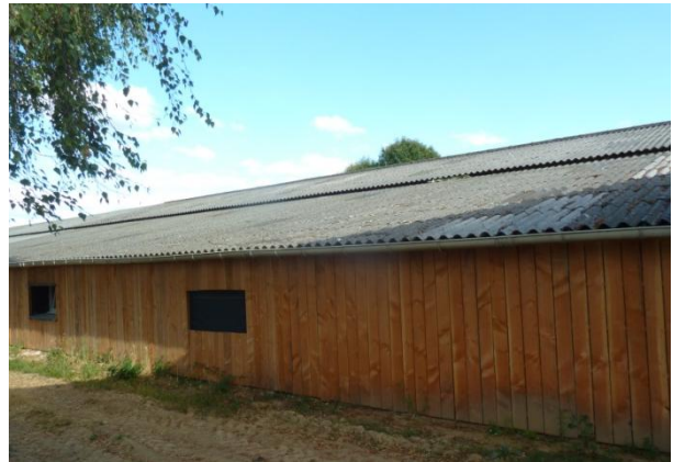
Figure 19: Bardage bois sur la fromagerie, Ferme de la Tournerie. (Source : de Galzain, 2016)
