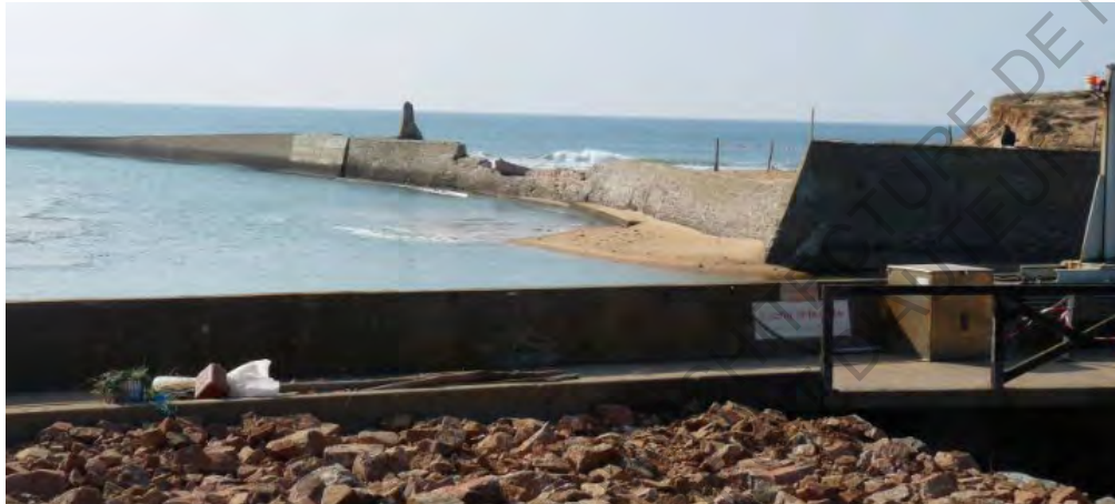
Photographie révélant l'endommagement de la jetée à Bretteville-sur-Mer, près de la Faute Source: Document public / Tempête Xynthia : compte rendu de mission préliminaire; Mars 2010 BRGM/RP-58261-FR
