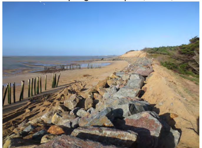
Enrochement pour préserver le cordon dunaire de l'Épine, 2010; Ile-de-Noirmoutier
