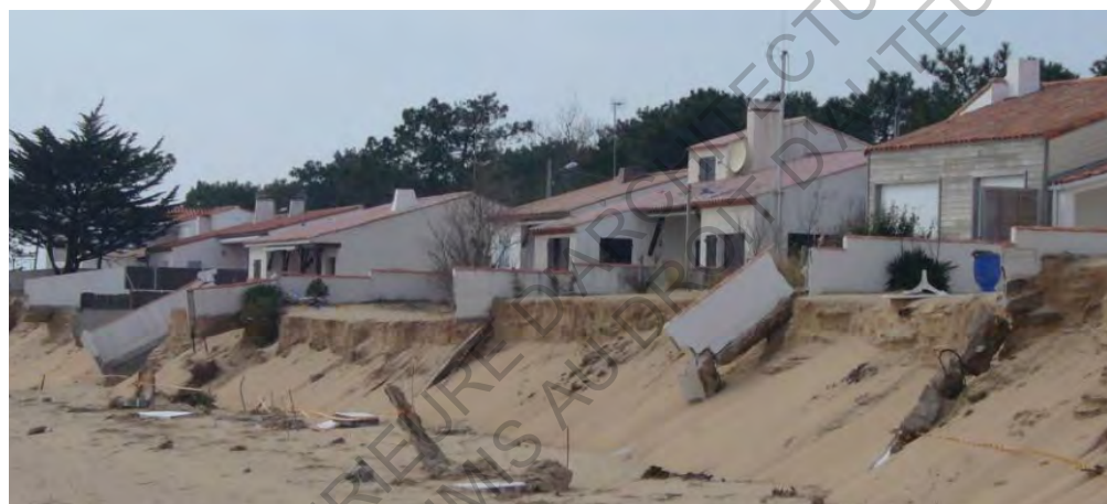
Photographie révélant les endommagements sur les maisons en première ligne, dus à l'érosion liée à l'action des vagues. Affouillement du terrain naturel sableux et déstabilisation des maçonneries, (La Tranche-sur-Mer, au lendemain de Xynthia).
