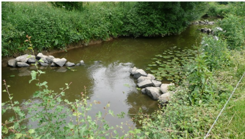
Figure 7 : Site d'étude 2 - Mise en place de blocs dans le cours d'eau (Source auteur)
