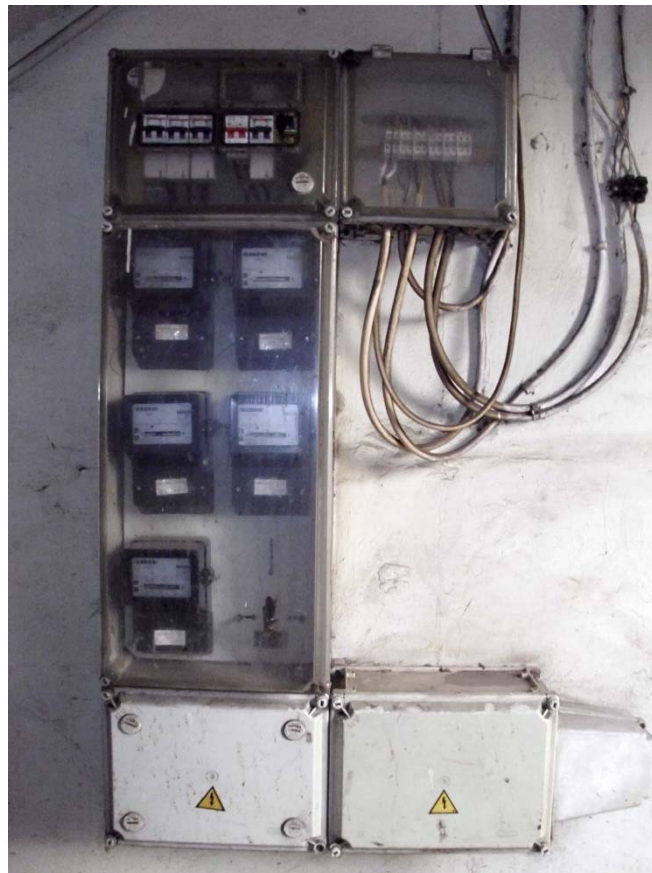
Figure 32 : Compteur d'énergie kWh
