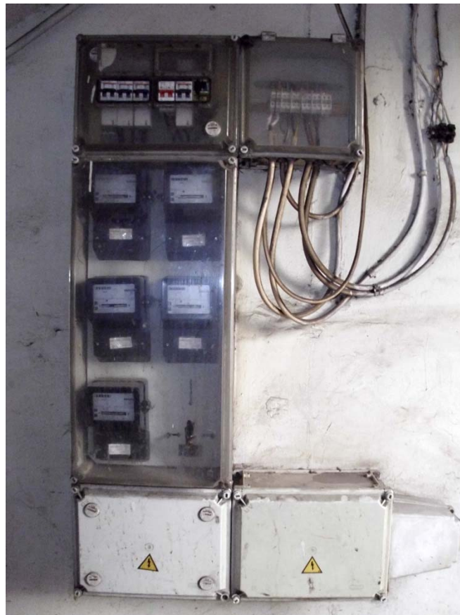
Figure 32 : Compteur d'énergie kWh
