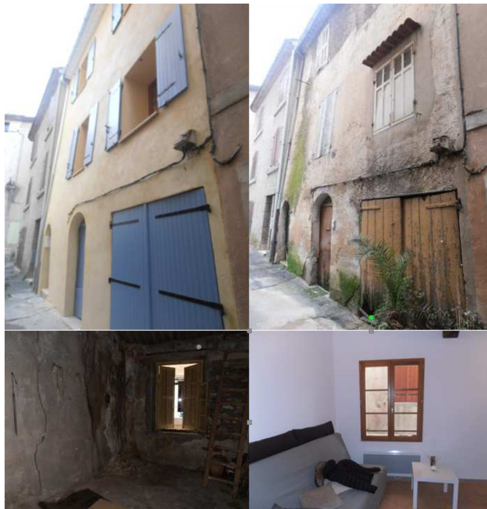
Figure 3) Prises de vue « avant/après » du 6 rue Fleury Aubagne (13), au cours de l'année 2015
