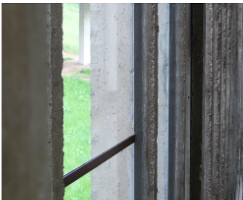
fig. 5 : Fenêtres au Couvert de la Tourette, simplement intégrées dans le béton, sans cadre.
