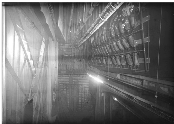
Figure 13 : Cintres permettant de faire coulisser les décors dans le plafond des Folies-Bergère, 1925 (photographie des frères Séeberger).
