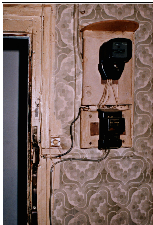
Photo 20 : installation électrique dans un logement
