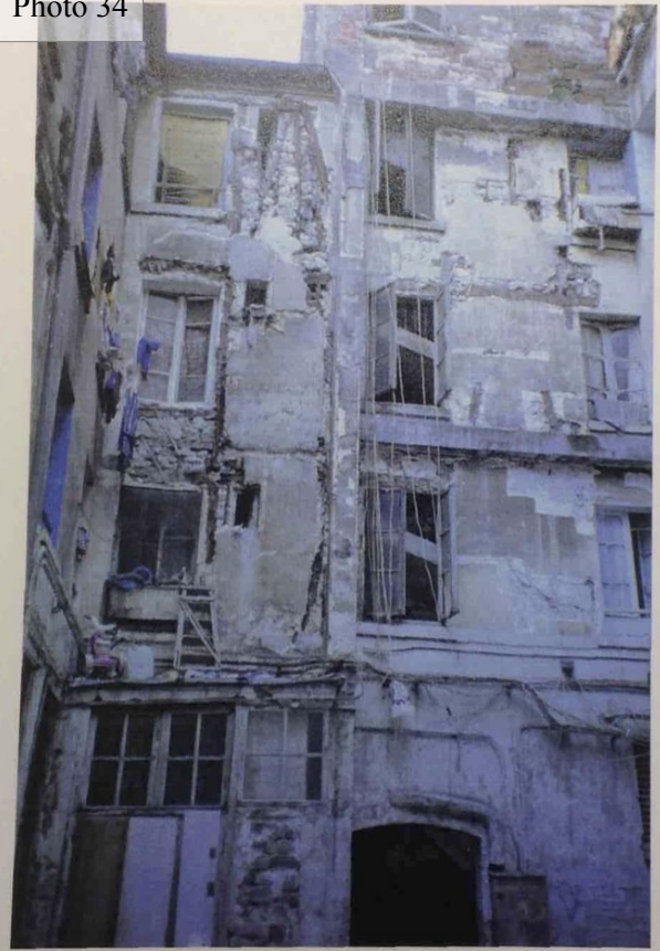
DEGRADATIONS SUR FACADE COUR COTE N° 7
