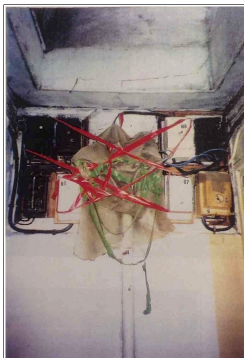
Photo 19 : installation électrique sous un vasistas
