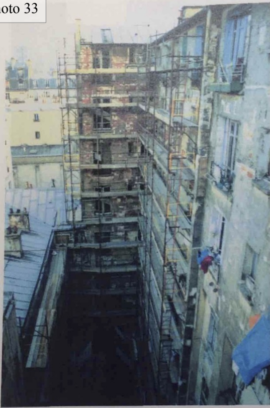
ECHAFAUDAGE POUR LA REPARATION DES FACADES COUR TRAVAUX EN EXECUTION D'OFFICE PAR LA PREFECTURE DE POLICE AU TITRE DES PERILS D'IMMEUBLE
