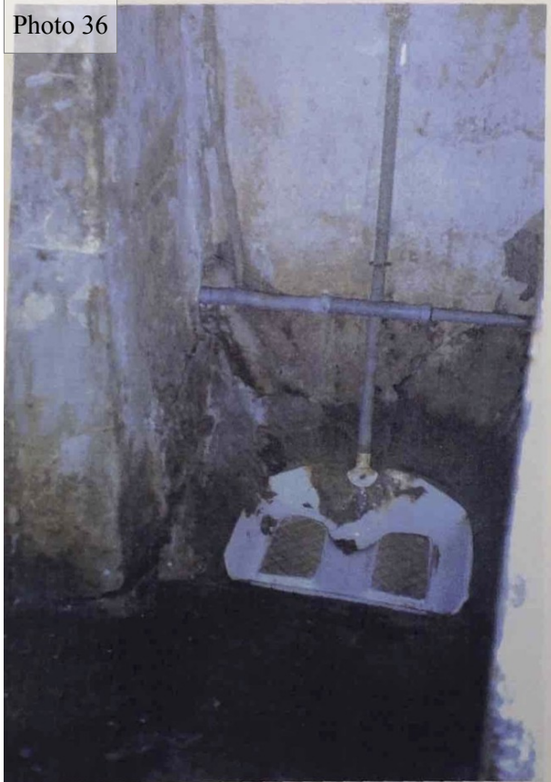
CUVETTE DETERIOREE, MURS ET SOL MINES RACCORDEMENT EAUX USEES DELICTUEUX
