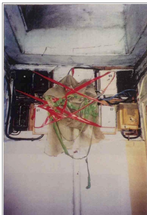
Photo 19 : installation électrique sous un vasistas
