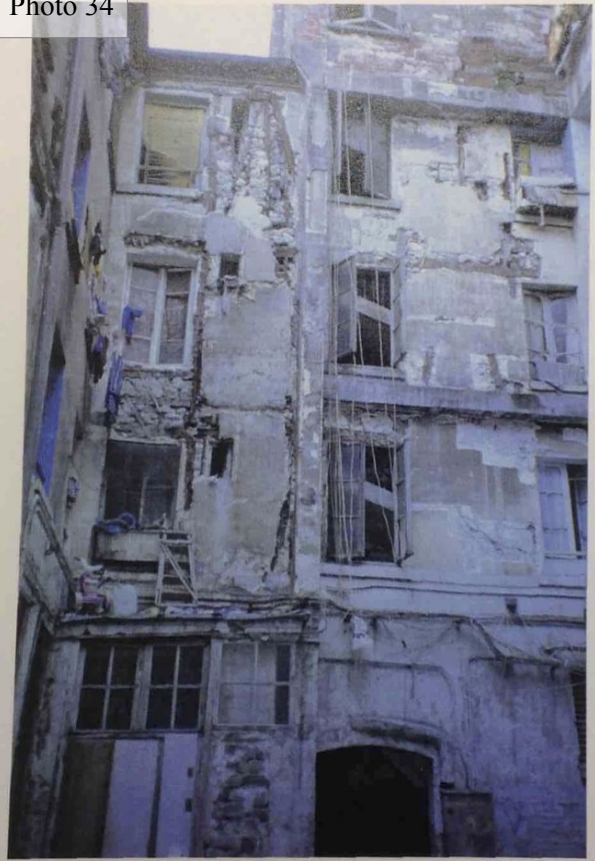
DEGRADATIONS SUR FACADE COUR COTE N° 7
