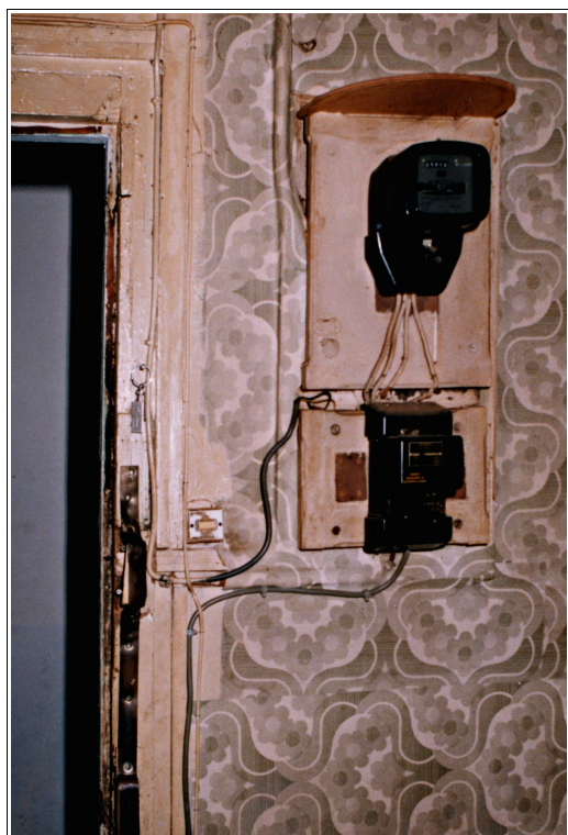
Photo 20 : installation électrique dans un logement
