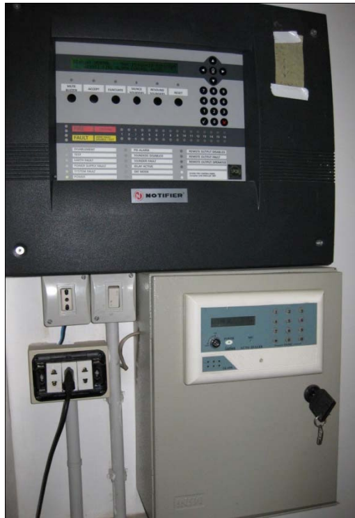
Figure 0.4 : Système de détection de feu et de mouvement avec composeur automatique
