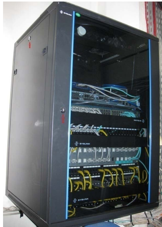
Figure 0.5 : Nouveau rack sécurisé
