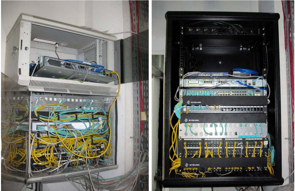
Figure 0.94 : Changement du rack dans SS
