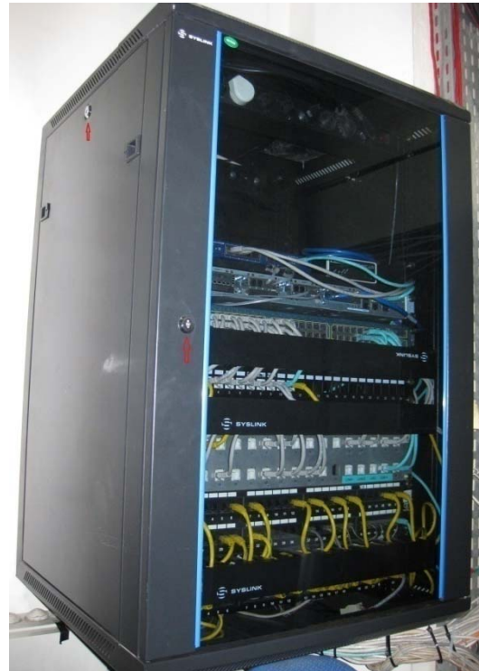
Figure 0.5 : Nouveau rack sécurisé
