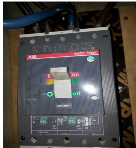
Figure III-20 : le disjoncteur ABB Tmax 3*400A installé dans l'hôpital.
