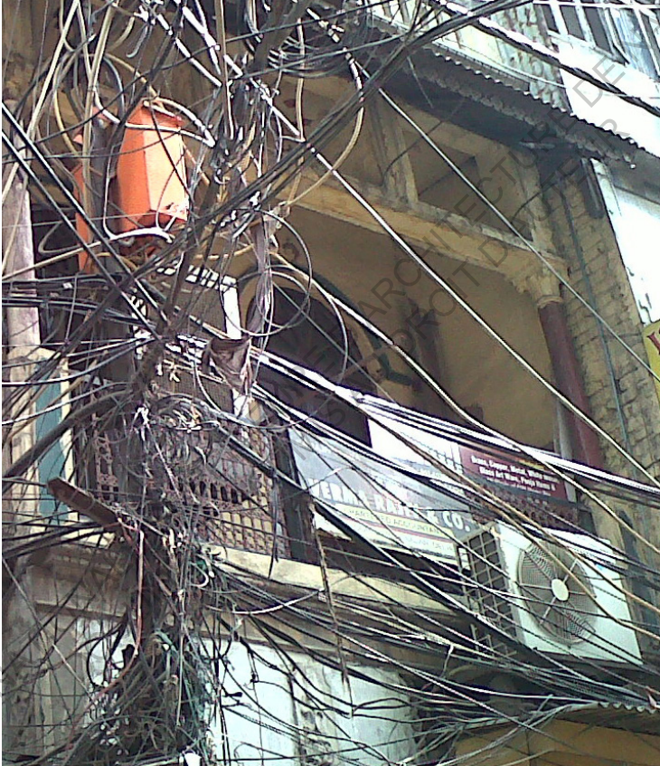
Noeud de fils électriques dans une courette
