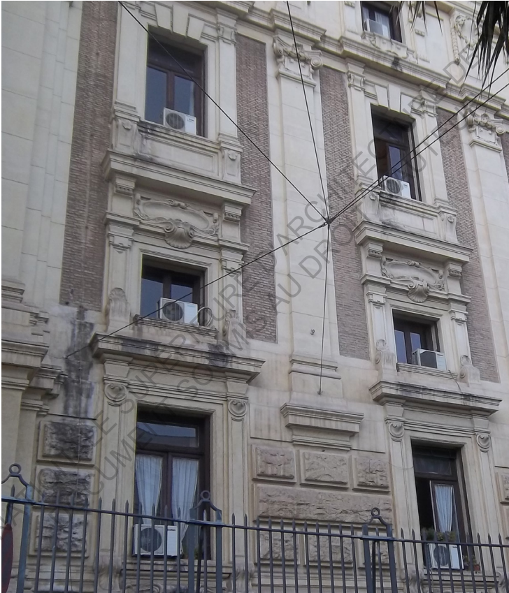
Exemple d'une façade "polluée" par les blocs de climatisation
