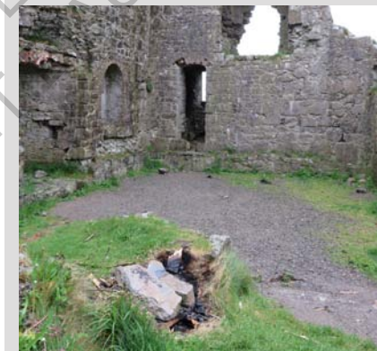
Fig. 81 - Dégradations, feu de camp
