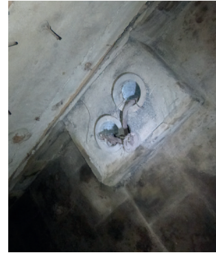
Câbles de raccordement au réseau téléphonique souterrain (A.Chaigneau)
