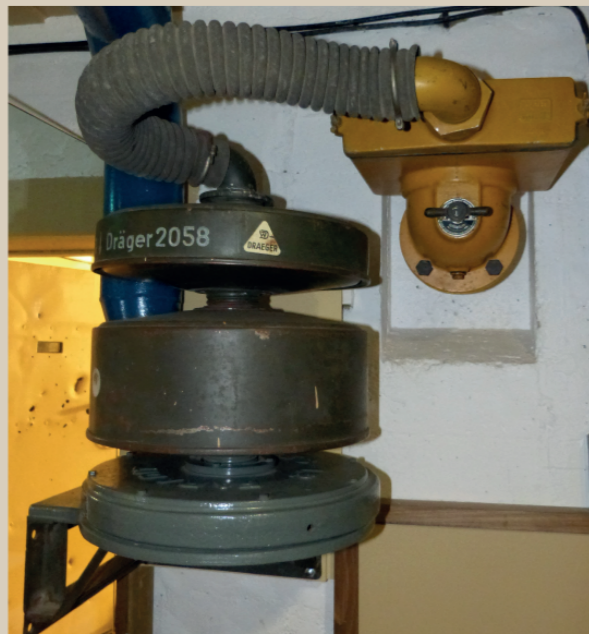
Ventilateur modèle HES 1.2 - Blockhaus du parc du phare du Cap Ferret (33) Ventilateur modèle HES 1.2
