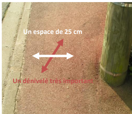
Figure 16 Trottoir trop étroit rue du Lavoir - Source personnelle
