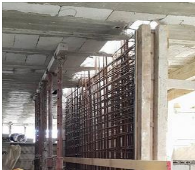
Figure 13 : Exécution d'un voile de contreventement dans une partie existante - Fidar – Liban (Bureau ASSAF)
