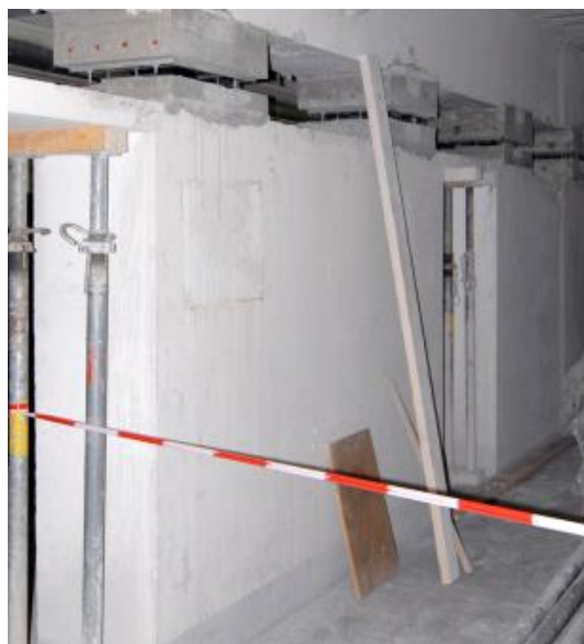
Figure 21 : Isolations parasismiques – Suisse
