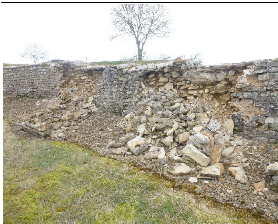
Illustration 19: Alésia : effondrement de la maçonnerie du théâtre
