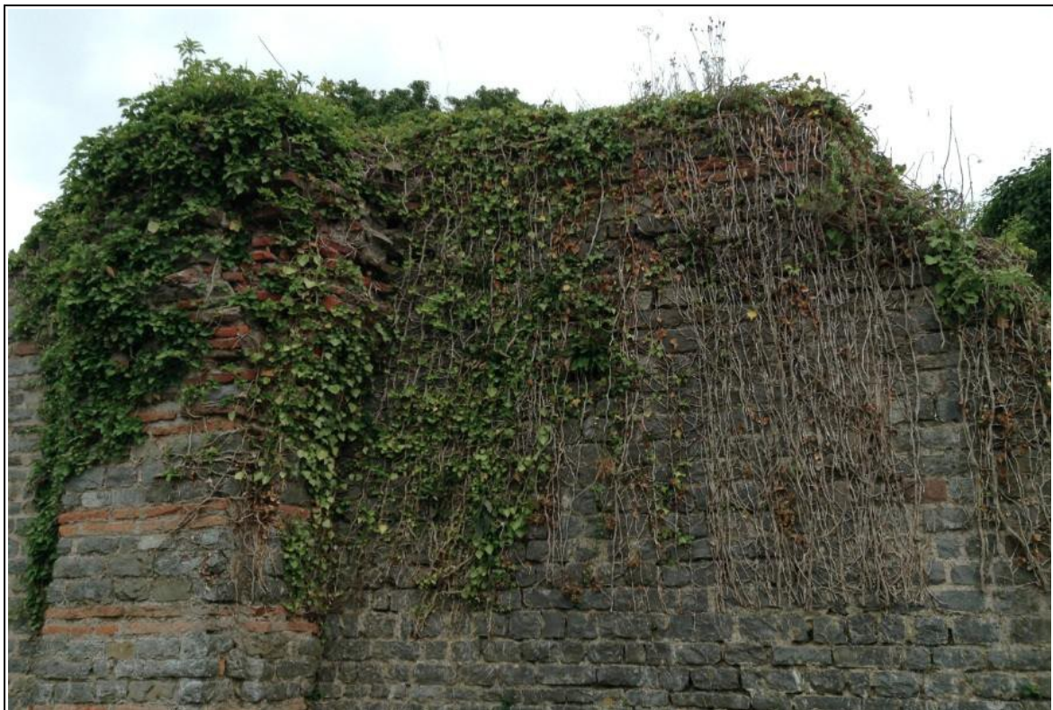
Illustration 38: Bavay : lierre sur une maçonnerie
