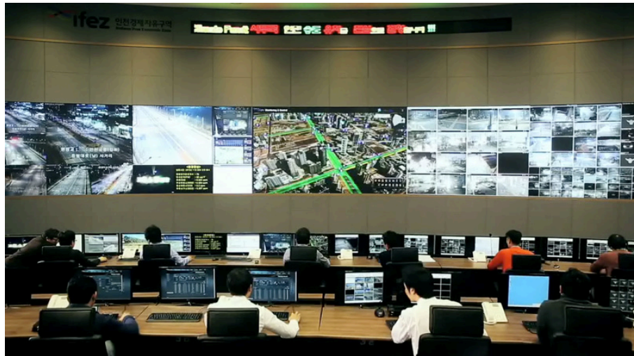
Le centre de contrôle des opérations intégrées de Songdo.
