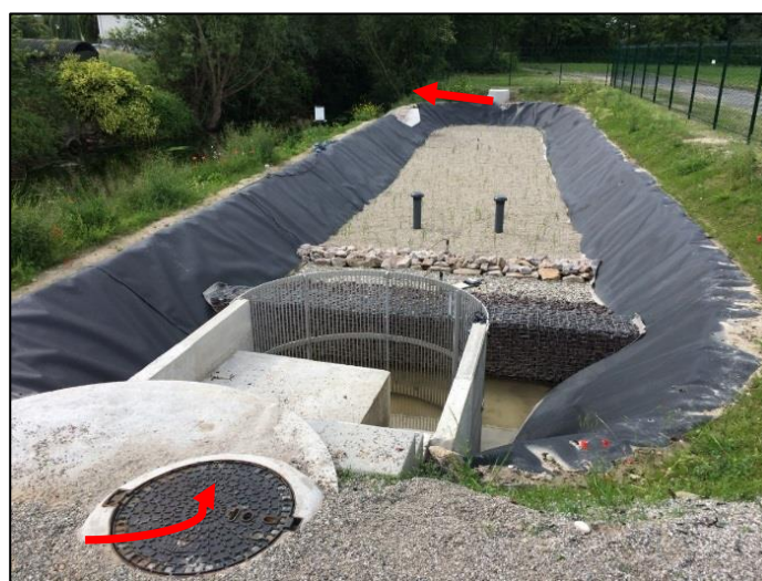
Vue du filtre planté de roseaux dans son ensemble. On distingue le regard de répartition, le dégrilleur, le massif, le trop-plein et le regard de sortie (la vanne de régulation du débit de sortie a été installée a posteriori) (29/10/2015)
