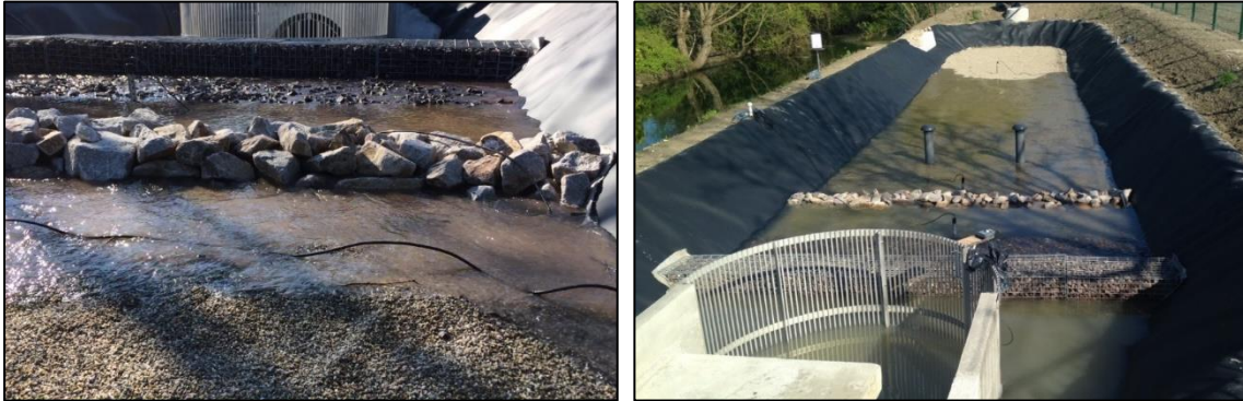
Alimentation horizontale avec présence d'un ruissellement surfacique (29/04/2016)
