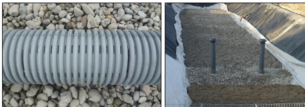
Photographies du drain et des cheminées d'aération en diamètre 150 mm (12/11/2015)
