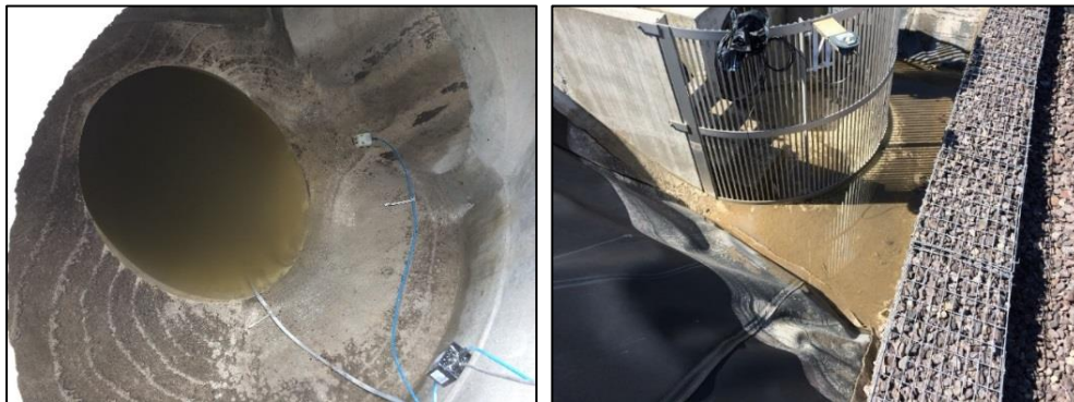
Figure 3-6 : Zones de dépôts dans le regard de répartition (gauche) et en amont des gabions (droite) (29/04/2016)
