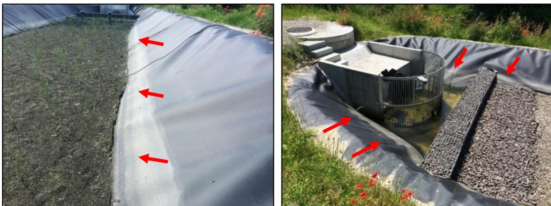
Figure 4-1 : Sollicitation de la géomembrane sur les parois latérales (24/06/2016)
