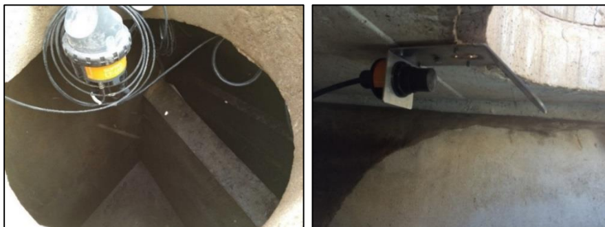
Figure 2-7 : Enregistreur-transmetteur de données (gauche) et sonde à ultrason (droite) installés dans le déversoir d'orage 8001 (22/02/16)
