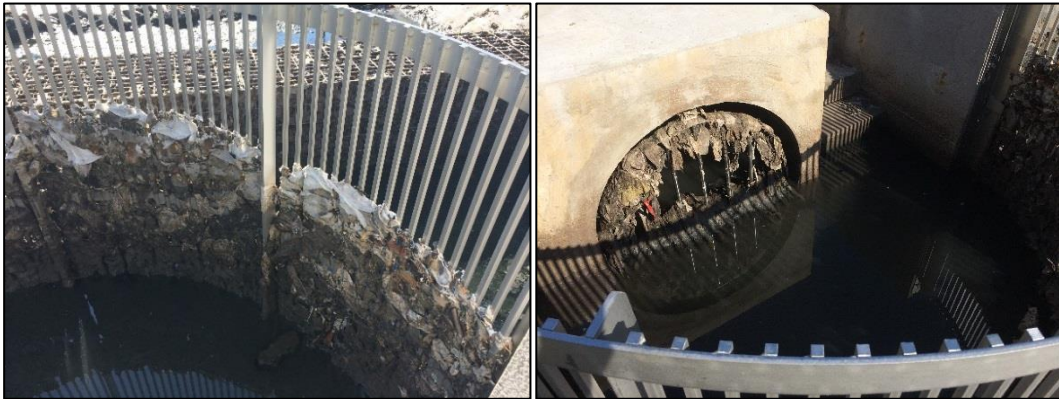
Figure 3-11 : Lingettes retenues par le dégrilleur (gauche) et la grille anti-intrusion (droite) suite à de nombreux déversements (24/06/2016)
