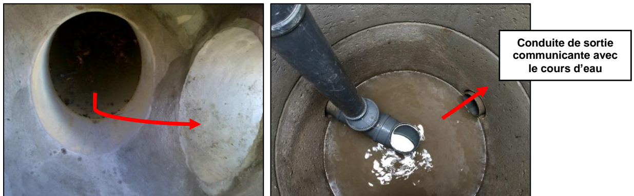
Vue de la conduite d'arrivée du siphon dans le regard de répartition, le départ vers le filtre est situé à droite ; système de maintien du niveau d'eau dans le filtre et tube permettant une mesure de niveau, situé dans le regard de sortie (29/10/2015)
