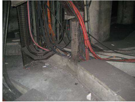
Figure 21: sortie de gaine en sous-quai M1
