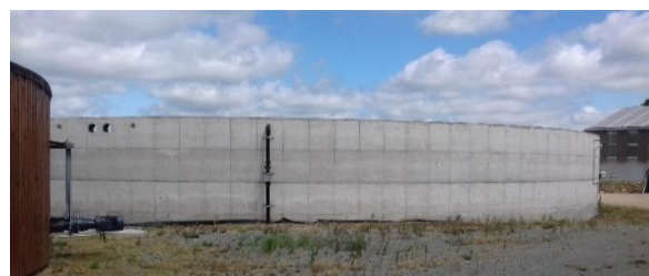
Figure 22 : Magny le Désert, cuve de récupération du digestat, 2017, Lecrosnier
