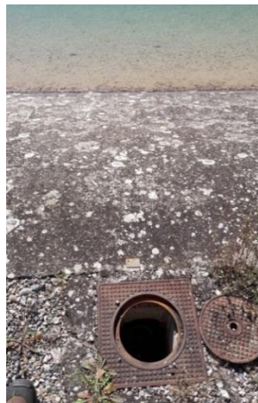
Figure 18 : piézomètre sur le canal
