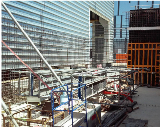
Figure XV - Échafaudage suite à l'accident
