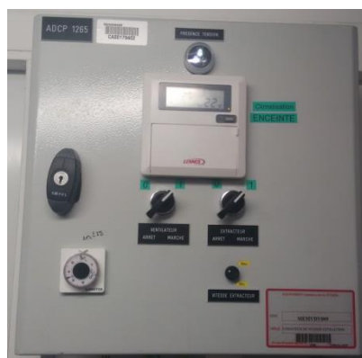
Figure 14 - Boîtier de contrôle de la ventilation générale du tokamak
