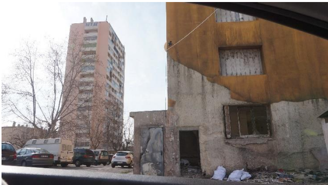
Figure 10 : Pied d'immeuble délabré d'un bâtiment au parc Corot Source : Photographie personnelle, mars 2017
