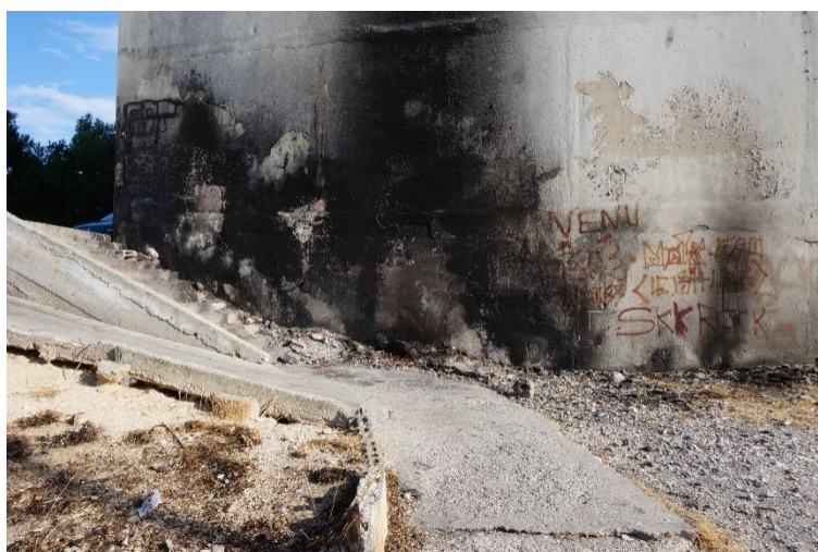
Figure 49 : Des traces d'incendies au pied d'un immeuble Source : Photographie personnelle, août 2017
