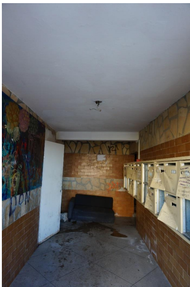
Figure 47 : Une entrée d'immeuble délabrée Source : Photographie personnelle, août 2017
