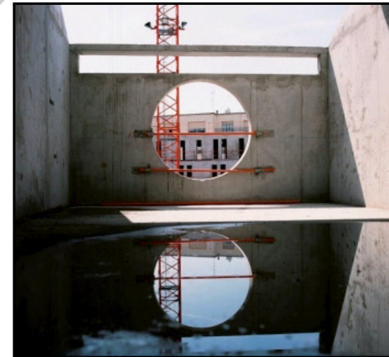
[Ci-dessus] Adeline BOMMART _ Piscine Molitor Suivi de chantier de la Piscine Molitor Paris, automne 2011 - mai 2014. Société : Colony Capital. Paris - Juillet 2013
